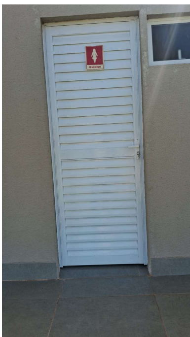
Foto 13 – Porta entrada do sanitário do WC-FEM
